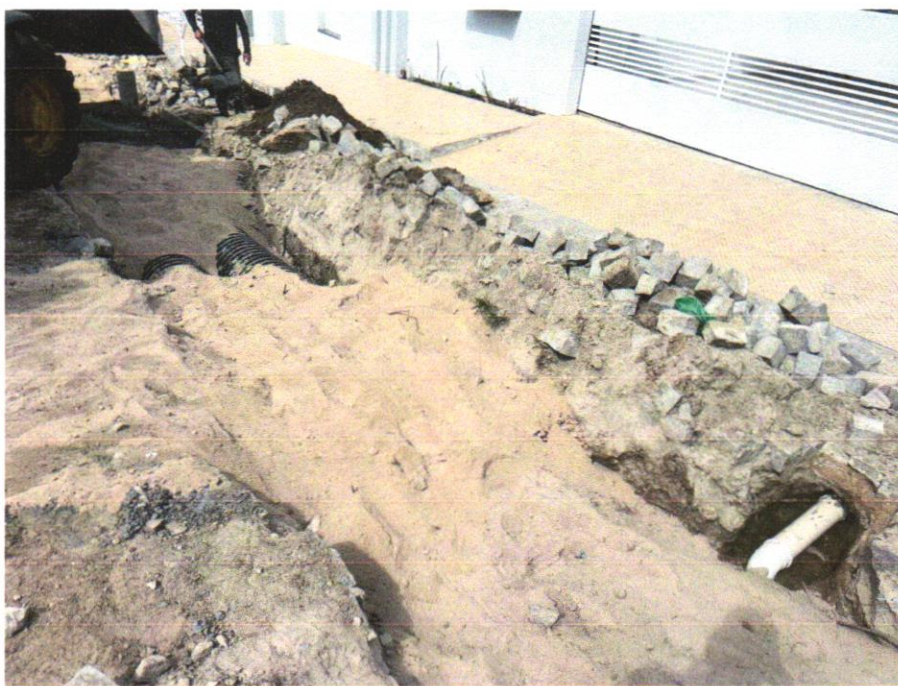
Foto 05 - ATERRO MANUAL COM SOLO ARGILLO-ARENOSO IMPORTADO E COMPACTAÇÃO MECANIZADA EM CAMADAS DE 0,20 M NO MÁXIMO
